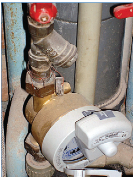
Рис. 1. Водомерный узел в квартире
